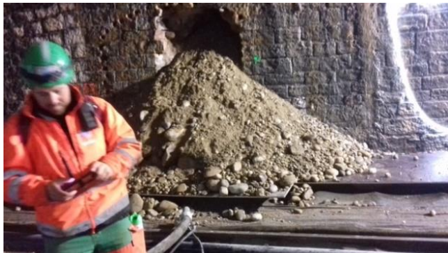
Venue importante de terrain à l'arrière du revêtement lors de travaux dans le tunnel de Caluire – mars 2019
