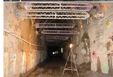
Rapprochement important des pénétrations (jusqu'à 50cm) dans le tunnel de Bolozon 2 – juin 2008
