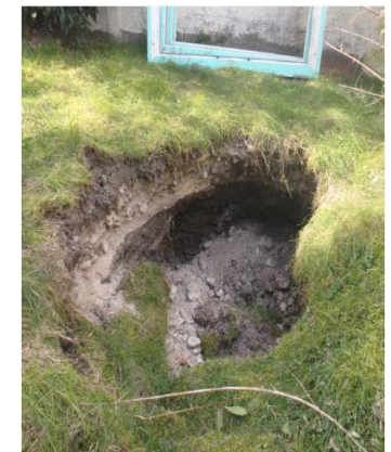
Fig. 2 : Fontis survenu à Sevrans (Source : Cerema)
